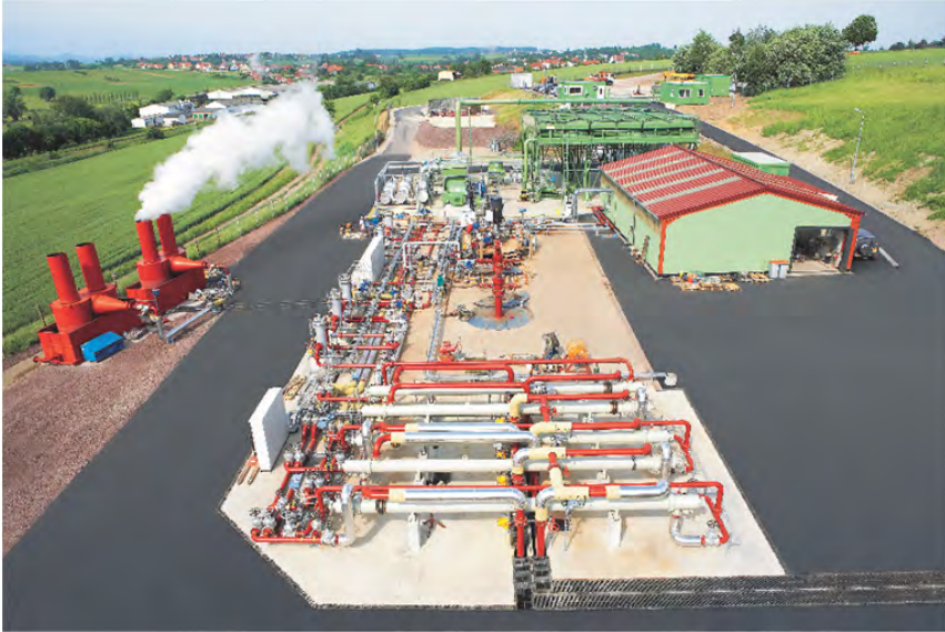
Abbildung 3.8: Das weltweit erste geothermische Kraftwerk, das nach dem HDR-Prinzip (siehe Abbildung 3.7) betrieben wird, in Soultz-sous-Forêts (Elsass).
